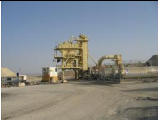
Central de fabricación de mezclas asfálticas en caliente
